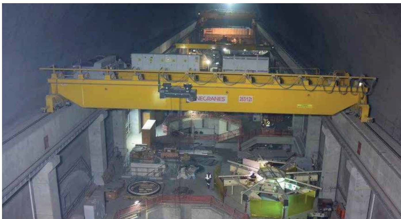
Pogled na kaverno in agregate 3 in 4 - ČHE Ingula v Južnoafriški republiki; foto: Arhiv HSE Invest
